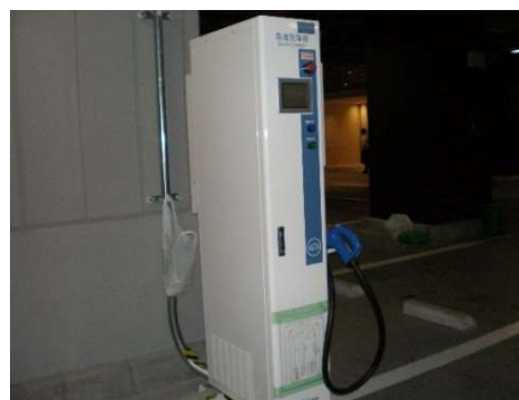
急速充電器の設置
